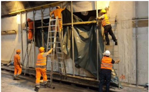
Galleria Melide-Grancia: primi interventi dopo dissesto del 08.06.2017
