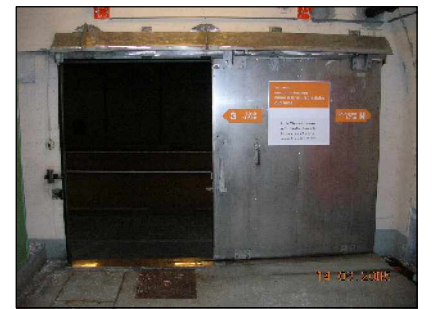
Porte rifugi lato galleria Adeguamento alle nuove normative 2005-2007
