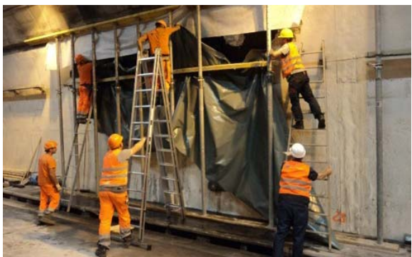
Galleria Melide-Grancia: primi interventi dopo dissesto del 08.06.2017
